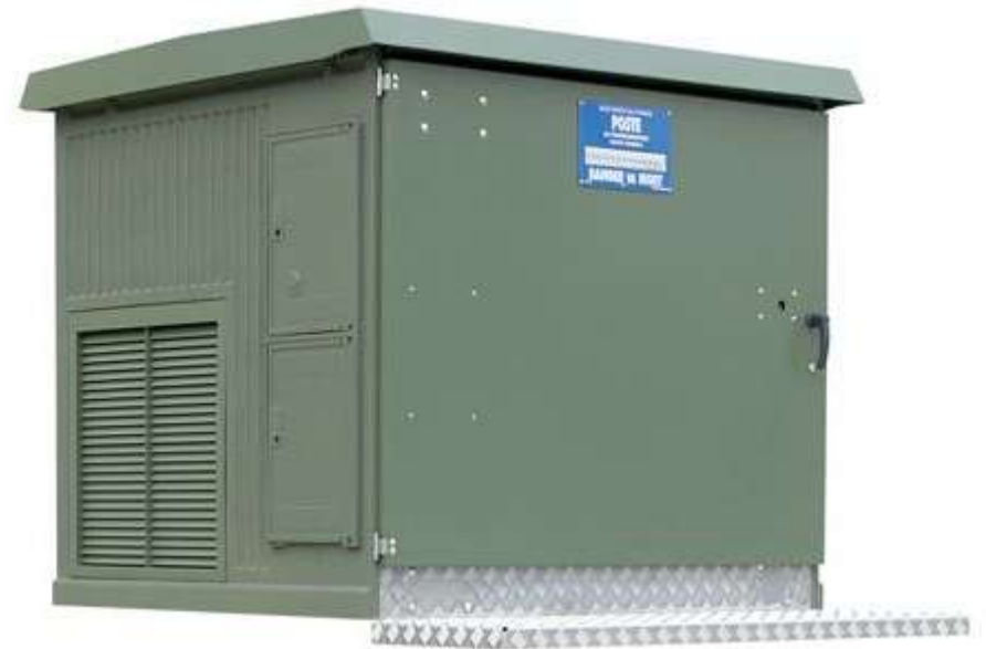
Poste de livraison BT
